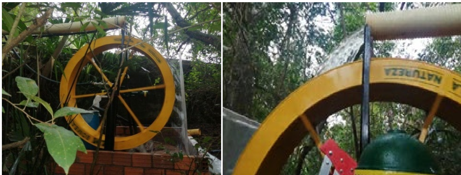
Figura 12. Montaje del conjunto de la Bomba ZM 95 MAXXI (izquierda); tubería de accionamiento del sistema (derecha).
