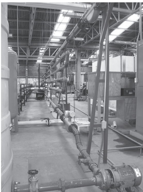
Figura 4. Vista lateral de la instalación piloto.
