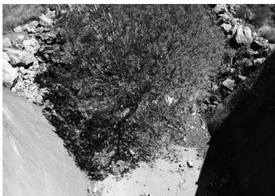
Figura 5. Gran árbol que crece justo debajo de la cresta de la presa en el canal del vertedero de una presa de tierra, bajo el puente de la cresta del vertedero de la presa. El canal continúa con una cubierta de enrocamiento a lo largo del talud de aguas abajo.
