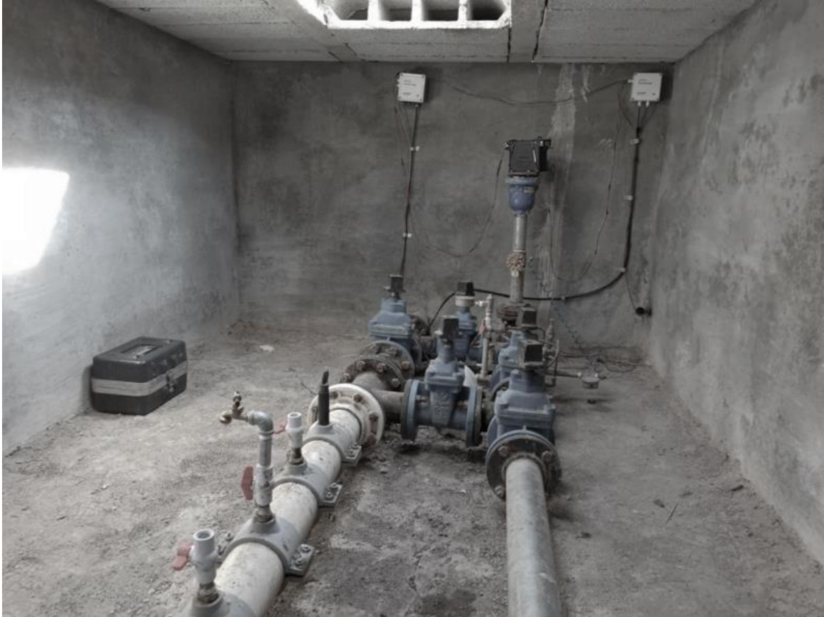
Figura 2. Estación de registro y envío de datos.
