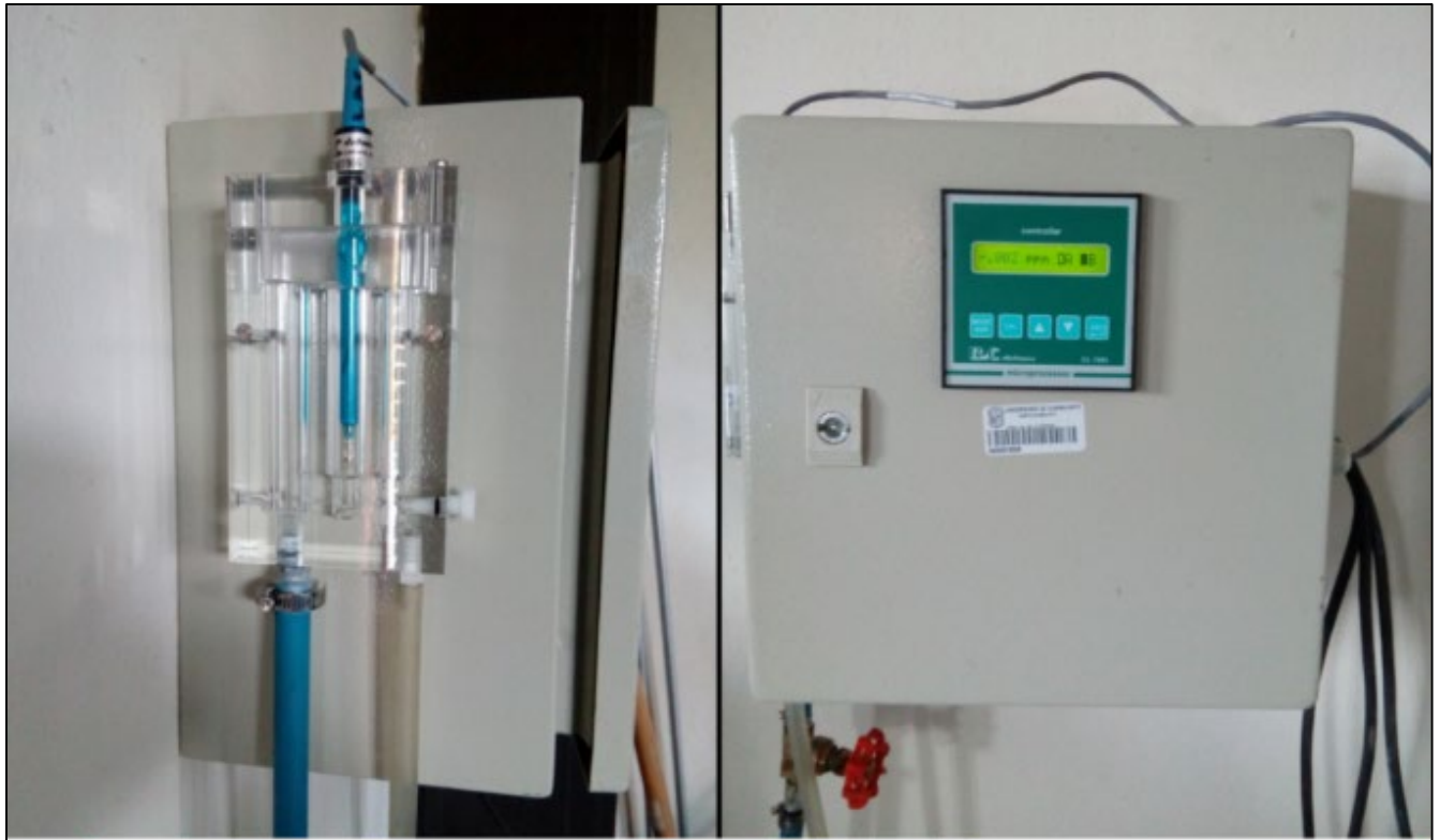
Figura 3. Controlador instalado en filtros.
