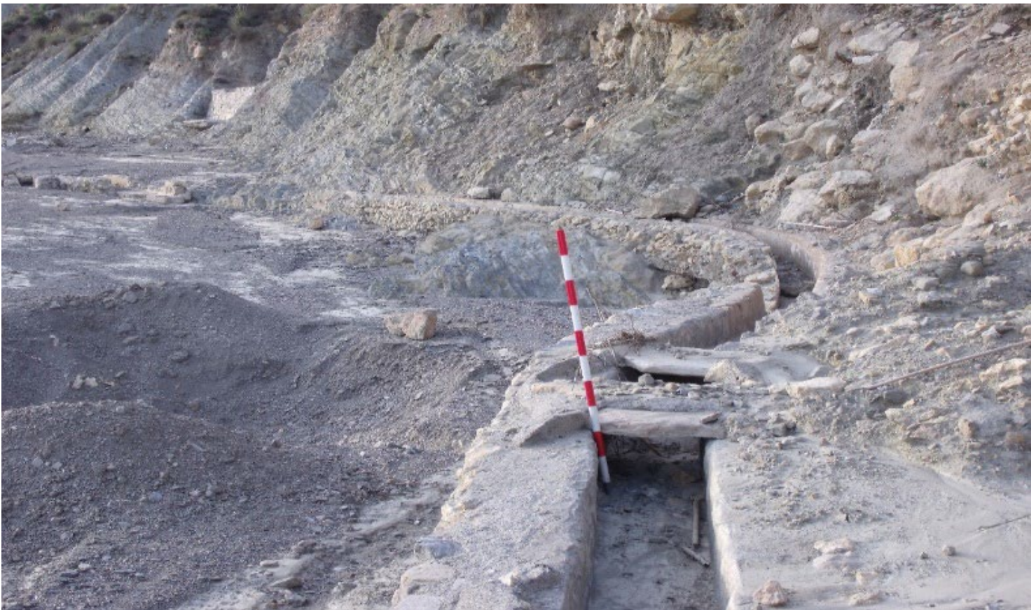
Figura 11. Rotura de la conducción de La Tercia a la balsa de Vilerda tras la avenida del 28-09-2012.
